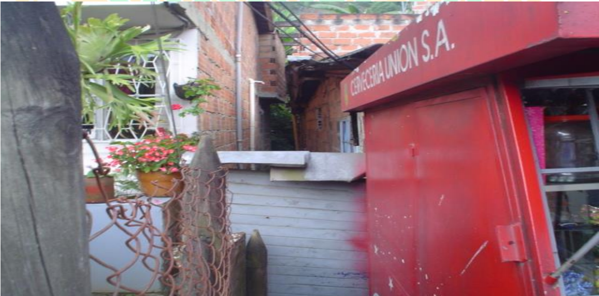
Figura 3. Zona de entrega de la Quebrada. Es una zona de 0.7m entre paramentos y por donde transita la Quebrada mediante tubería de 10". Justo al pie de la caseta roja se encuentra el sumidero de descarga.
